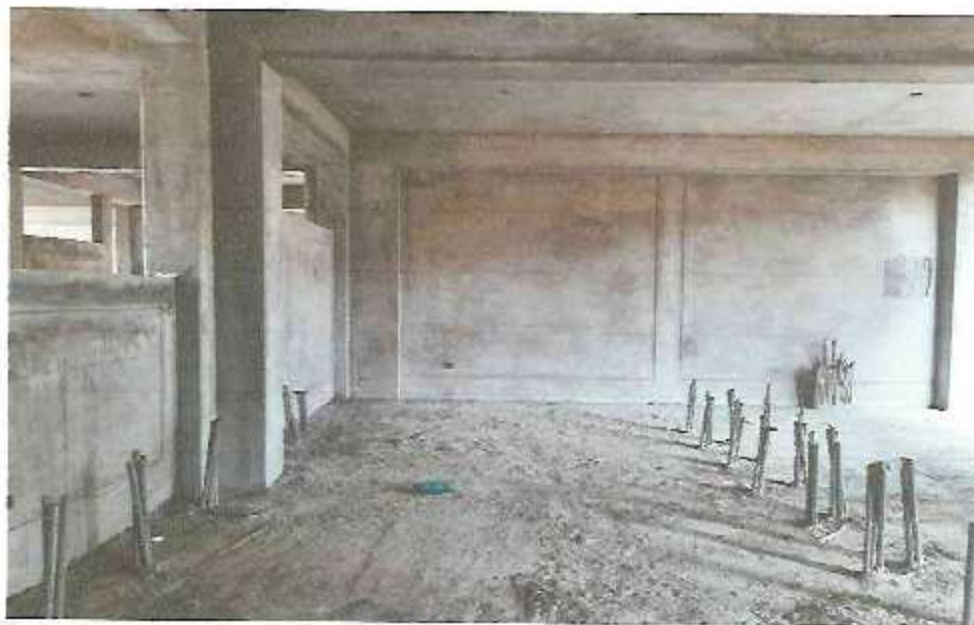
FOTO N°16: Cuijinado de tarrajeo de muros/columnas y vigas segundo nivel modulo III
