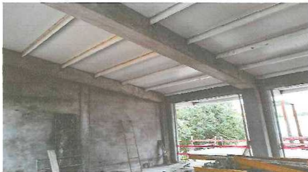
FOTO N°20: Culminado de tarrajeo de muros/columnas/vigas y colocación del panel termoacústico tercer nivel modulo IV
